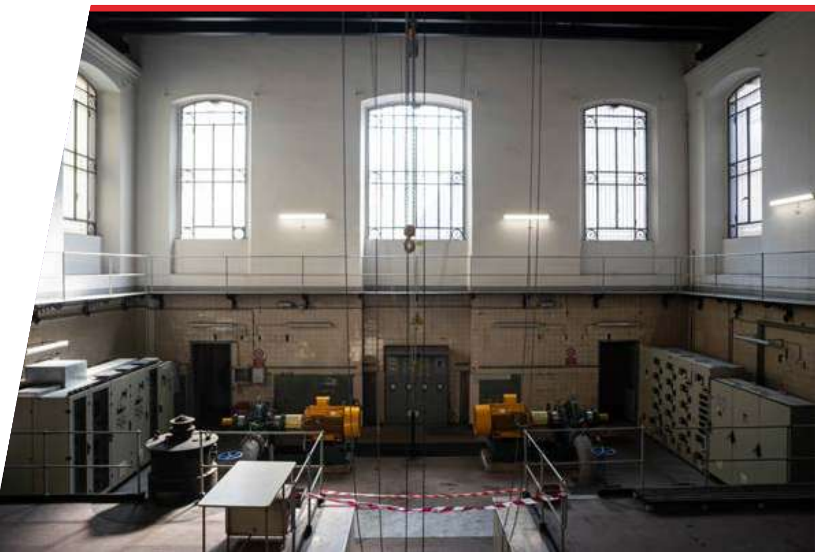
L'interno della centrale dell'acquedotto di via Anfossi
