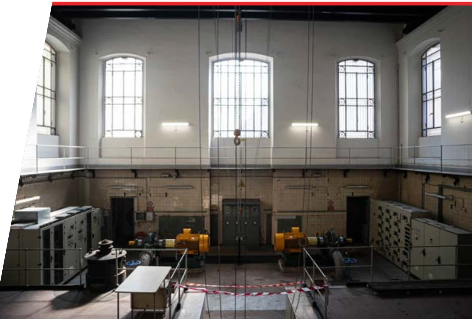
L'interno della centrale dell'acquedotto di via Anfossi
