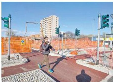
LAVORI IN CORSO Il cantiere della nuova pista ciclabile fra via Boifava e Missaglia (Newpress)
